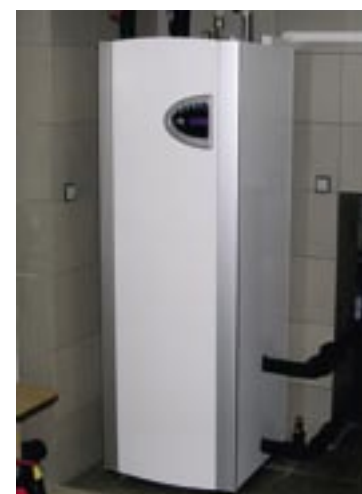
Tepelné čerpadlo IVT Greenline C s vestavěným nerezovým bojlerem zabírá v domě minimum místa.
