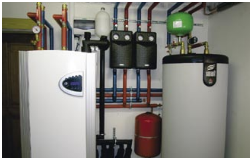
Výběr kvalitního tepelného čerpadla je stejně důležitý jako jeho správná instalace. Proto ji svěťte zkušené firmě. V IVT klademe důraz na kvalitu řemeslné práce i na estetické provedení kotelny.
